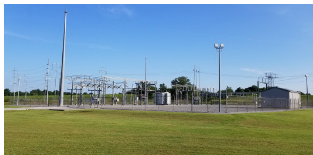
Poste d'alimentation de l'Union City Electric Authority adjacent au site
